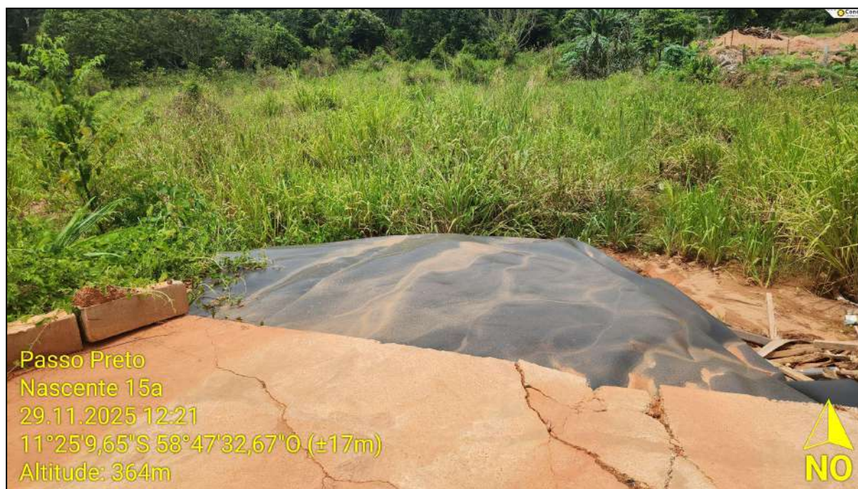
Fig. 88 - Dissipador que leva a água de parte da nascente 15a que foi drenada em virtude da construção da pavimentação asfáltica.
