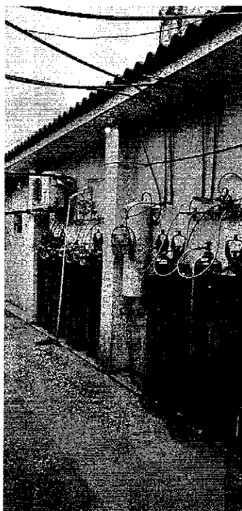
(Foto 02) – Central de gás
